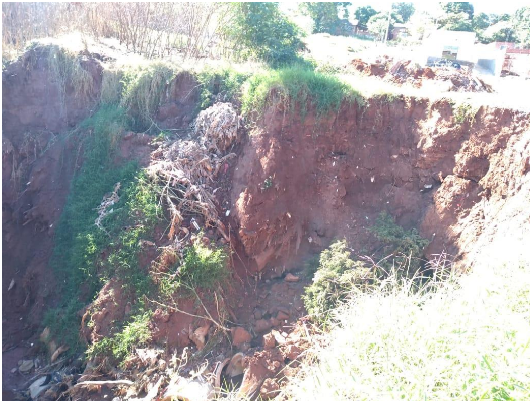
Erosão Córrego Arurão
